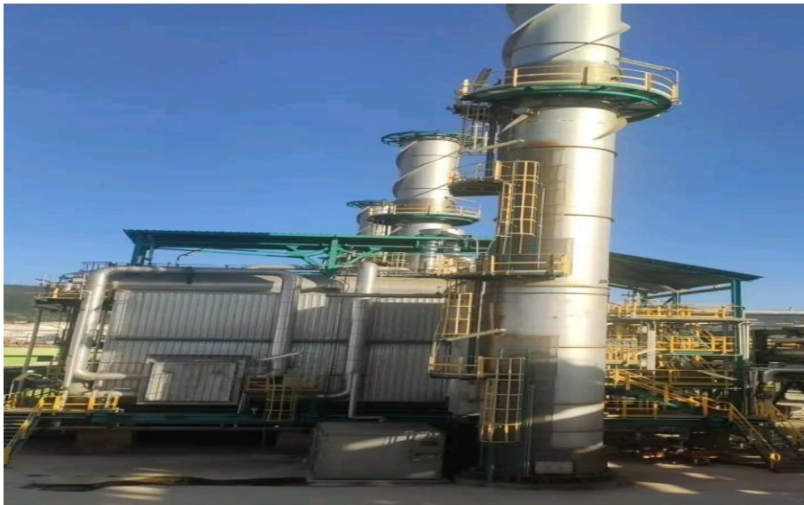
Figure III.6 : Chaudière de la CTE 2
