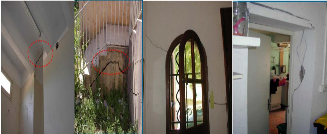
Figure 6 Formes de dégâts sur des bâtiments reposant sur des terrains gonflants (Mouroux Pet al 1988).
