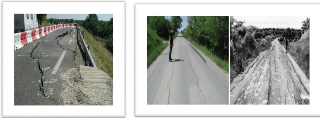
Figure 7 Fissuration longitudinale de routes due au retrait et gonflement des sols (Ferrah. F. 2006).
