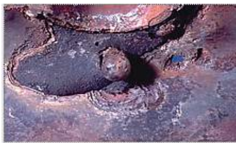
Figure I.8: Corrosion galvanique au niveau d'une zone de brasage entre la brasure Cu-P et le tube en cuivre [33].
