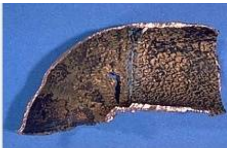
Figure I.13 : corrosion-érosion d'un tube en cuivre véhiculant de l'eau [33].
