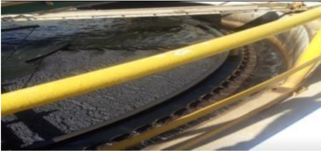
Figure. II .5 : Bassin de flottation à air dissout TN-4A.
