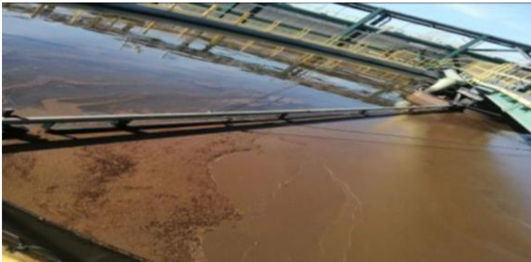
Figure.II.8 : Clarificateur pour séparer la boue biologique CL-1A/B.
