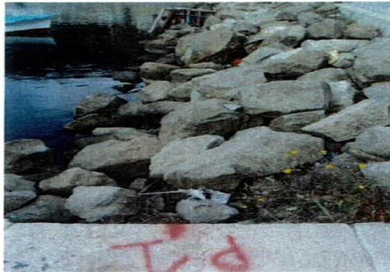
Figure IV.10. Talus dégarni aux alentours du niveau zéro
