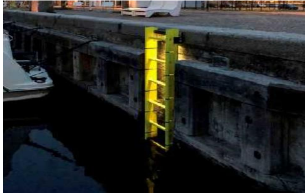
Figure VI.19. Echelle de sécurité dans la poutre de couronnement.
