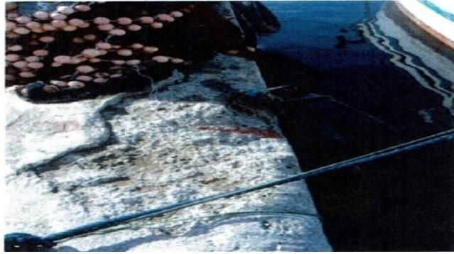
Figure IV.9. Décollement de la chape en bordure du quai.
