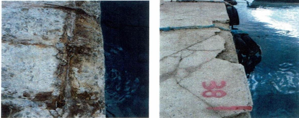
Figure IV.7. Décollement de la chape (cassée et fissurée) et bordure de quai partiellement endommagée.
