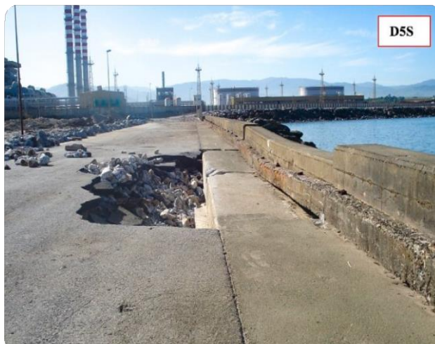
Figure II.2. Effondrement de la chaussée du terre plein.
