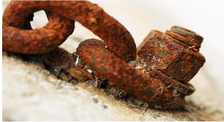
Figure. I.2 : Corrosion d'éléments en acier [5]
