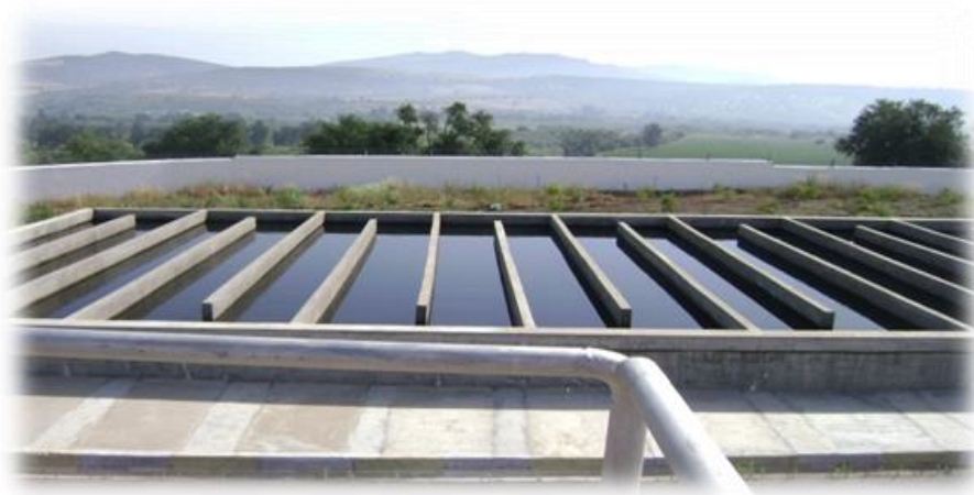
Fig.10 : Bassin de désinfection (Photo personnelle)
