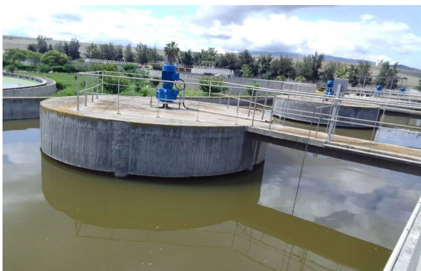
Fig.07 : Bassin d'aération (Photo personnelle)
