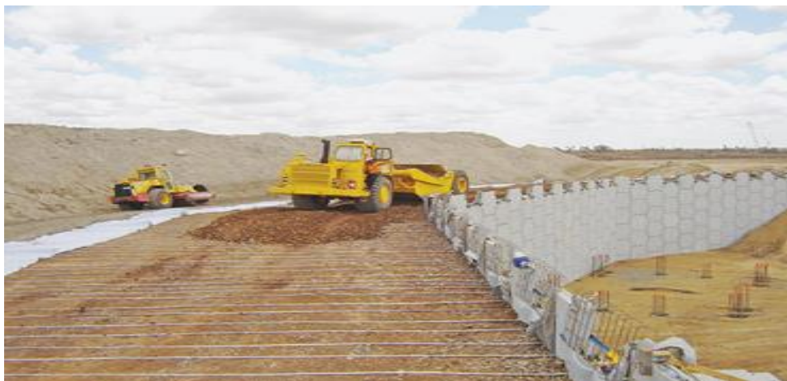
Figure 3 : La stabilité de l'ouvrage est assurée par le frottement entre les armatures et le sol.
